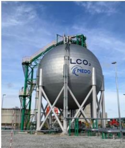
液化CO 2 貯槽※ 2
