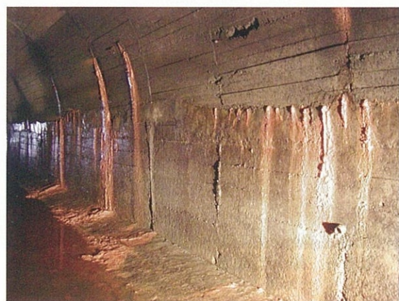
既設トンネル状況（漏水、亀裂）
