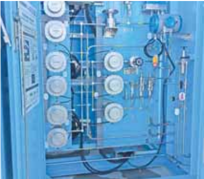
コンプレッサーからの配管と蓄圧器から送り出す水素の配管が納められたバルブユニット
